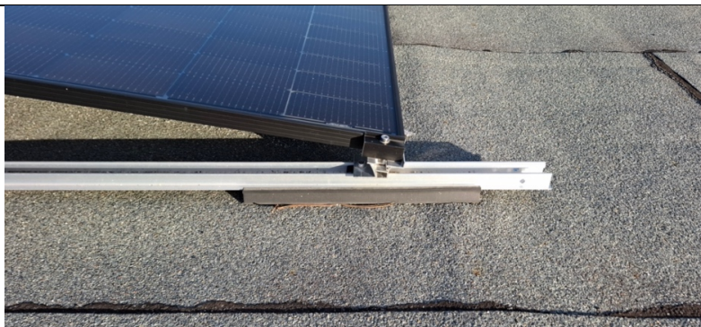
Foto 3: Bautenschutzmatte aus EPDM zwischen Schiene und Dachhaut
