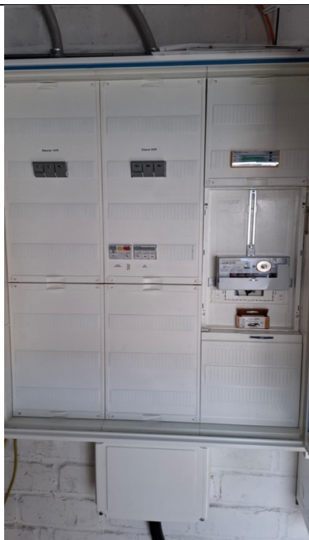
Bild 8: Anschlusskasten mit Anschluss Wechselrichter, NA- Überwachung und Funk- rundsteuerempfänger
